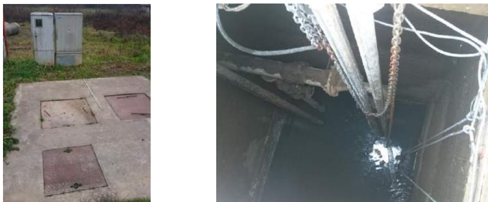
Slika 1.3 Postojeći sustav odvodnje u Garešnici – crpna stanica
