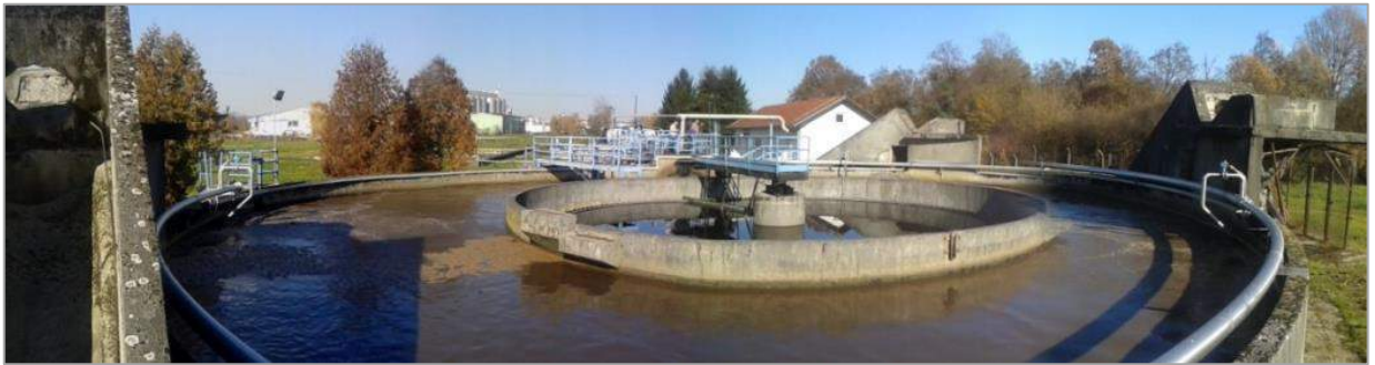
Slika 1.9 Biološki tretman na UPOV-u Garešnica: Bioaeracijski bazen i sekundarni taložnik
